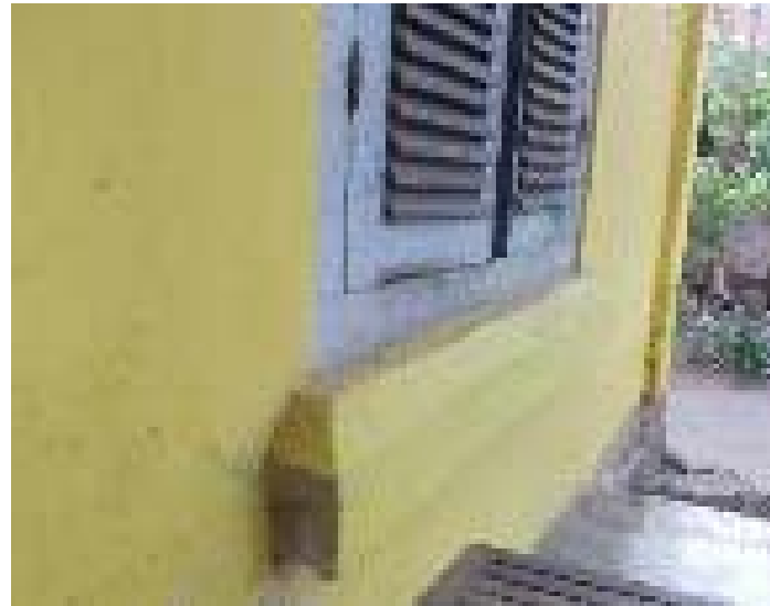
Subsille pada ambang bawah jendela Bangunan bekas Rumah Dinas PG Kalasan milik Bapak Joyomulyo
