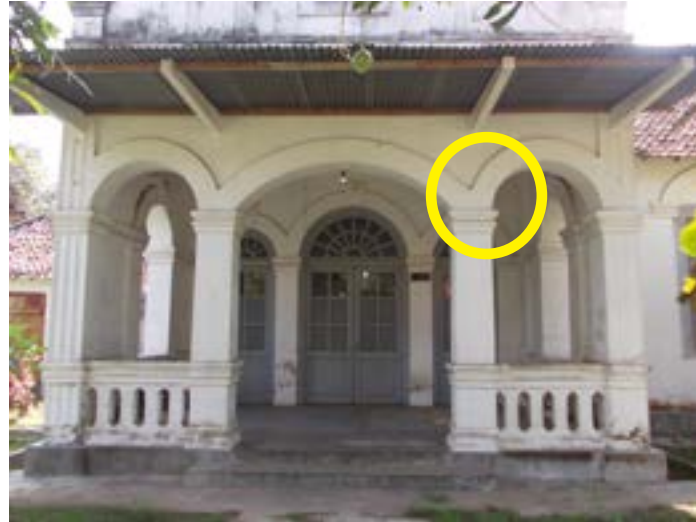
Impost pada bangunan Eks Rumah Dinas Pabrik Gula Sewugalur milik Bapak Suyitno
