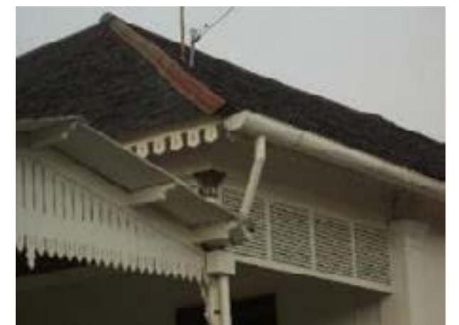
Sistem gutter pada gedung Sasmitaloka, Bintaran
