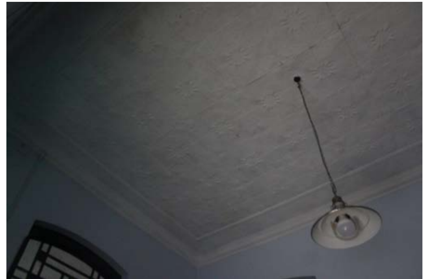
Plafon dari gypsum di klinik pratama Detasemen kesehatan wilayah 04.04.02
