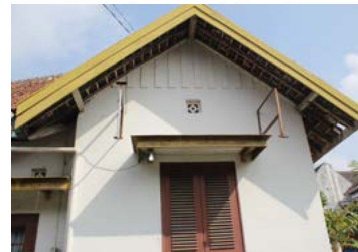
Pelipit pada gable bangunan rumah tinggal di kompleks HKBPI di Jl Dewa Nyoman Oka No. 20
