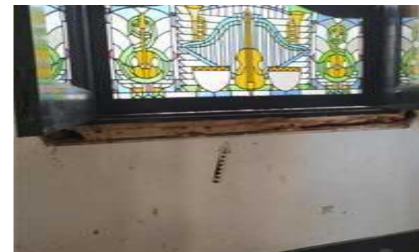
Kondisi kusen jendela setelah dibongkar sumber : Dokumentasi Penulis
